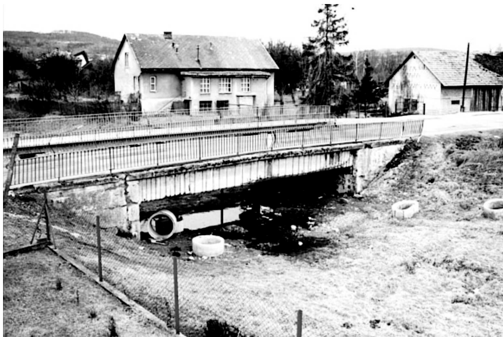
Most w centrum Rudawy zniszczony przez pojazdy ponadnormatywne przewożące kamień.
